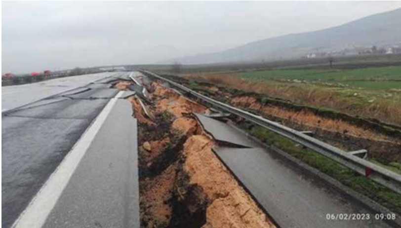
Şekil 2. Tarım arazileri üzerinde yapılan Adana-Gaziantep otoyollarının depremden yıkılmış görüntüleri.
